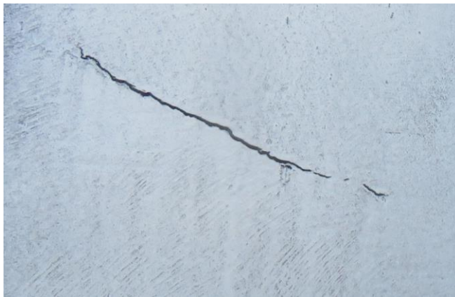
Рисунок 1- Трещина в основном металле трубопровода
