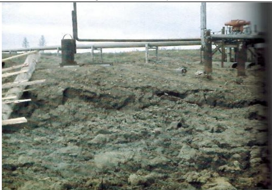
Рис. 9. Сплыв на трассе трубопровода (фото С.Ю.Пармузина)
