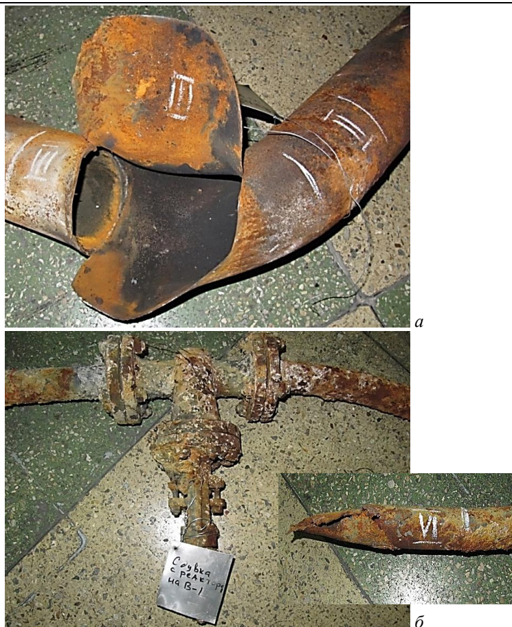
Рис.8. Общий вид элементов трубопровода: а – элемент трубопровода выхода этан-этиленовой фракции из реактора на фильтр; б – элемент линии сдувки из реактора турбокомпрессора
